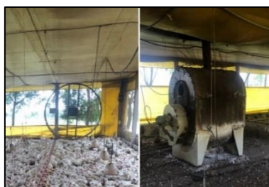
Figura 2. Sistema de ventilação para resfriamento e aquecimento a lenha.
